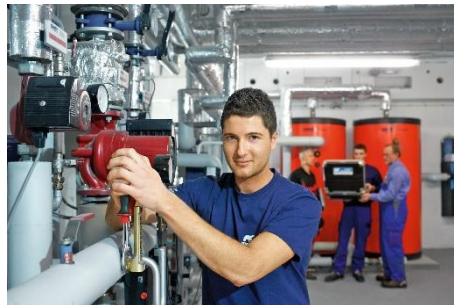
Dussmann Technical Solutions: Kälte- und Klimatechnik
